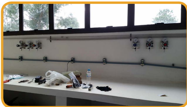
Pontos de gases para os equipamentos ICP-MS, PerkinElmer.
